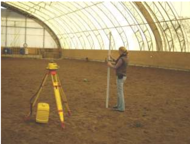
Vérification des niveaux de surface d'entraînement avec un niveau laser pour établir les pentes précises.
