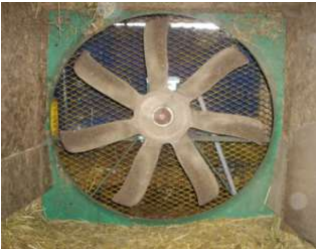
Photo 2 – Ventilateur axial vue de l'intérieur de la gaine
