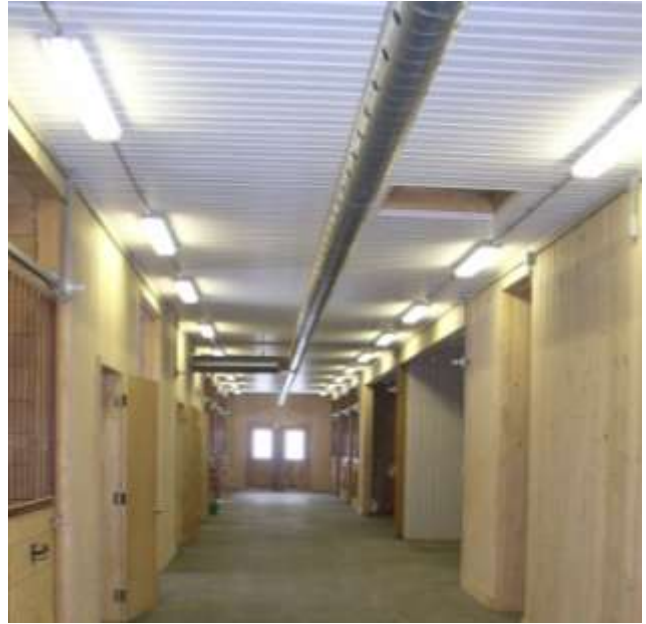
Un conduit de distribution de l'air est un système souvent utilisé.
